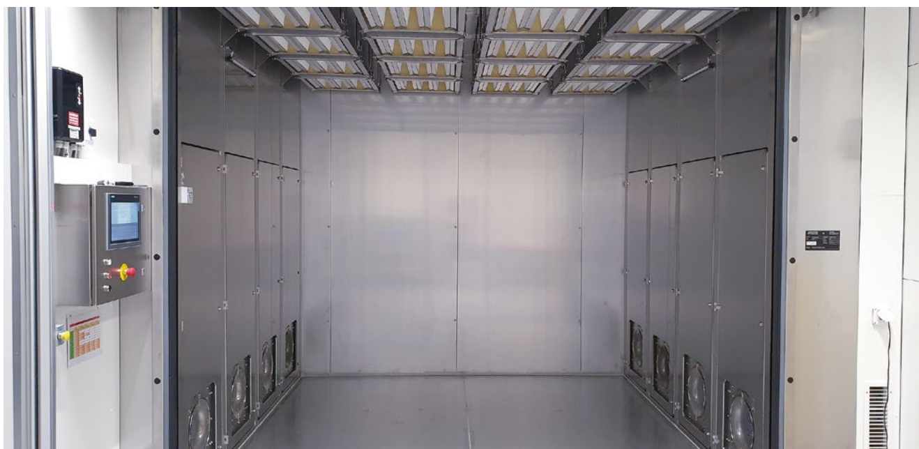
Durch den separaten Großraumtrockner konnte die Reinigungskapazität nahezu verdoppelt werden.
