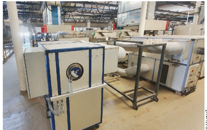
Die Entfeuchtungsmodule stellen die erforderliche trockene Prozessluft für die Trockner bereit.
