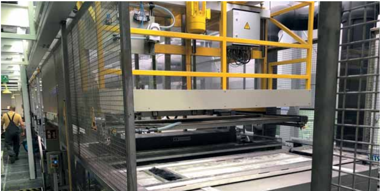
Jede Trocknungsstation verfügt über ein automatisches Deckelsystem, das die wertvolle Wärme im System hält. Die Trocknung findet im lufttechnisch geschlossenen System statt
