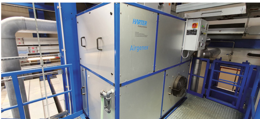
Isolierte Luftkanäle verbinden die Trockner mit dem Airgenex®-Entfeuchtungsmodul, das die erforderliche Prozessluft aufbereitet (Bild: Harter GmbH)
