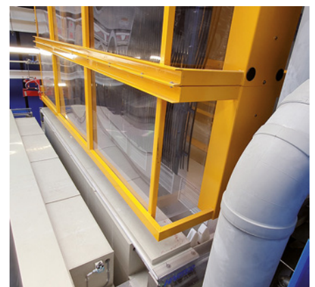
Fahrwagen beim Einfahren eines Gestells in den Trockner (Bild: Harter GmbH)
