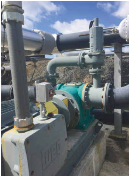
Die Notos-Schraubenspindelpumpe sorgt im Ölterminal für Effizienz und Zuverlässigkeit
