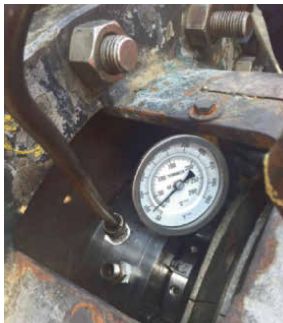
Nach der Umrüstung mit neuer Dichtung und Temperatursensorik tritt kein Schwefel mehr aus
