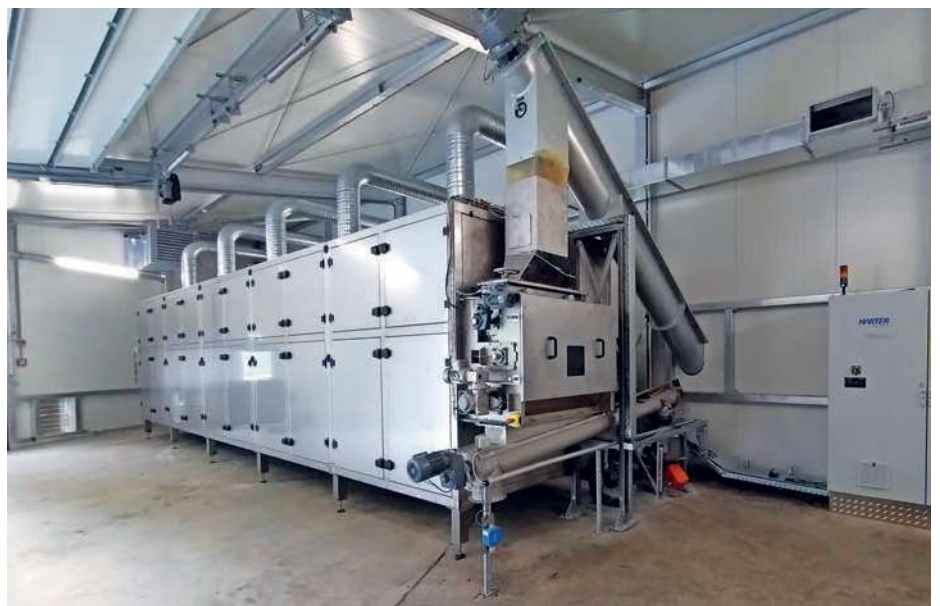
Die Klärschlamm-trocknungsanlage in Erpfendorf besteht aus fünf Wärmepumpenmodulen – diese stellen die erforderliche Prozessluft bereit und sind ebenso für den Kondensationsprozess verantwortlich.
